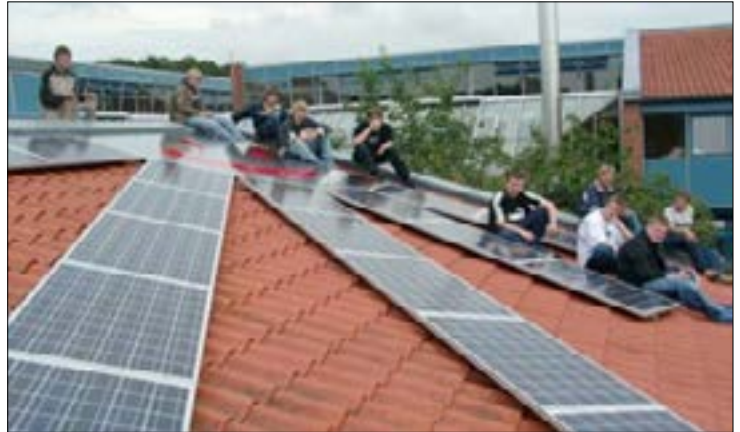
▲ Các tấm pin mặt trời trên nóc nhà của một trường học tại thị trấn Saerbeck
